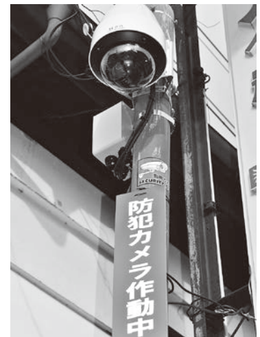
設置された防犯カメラ
