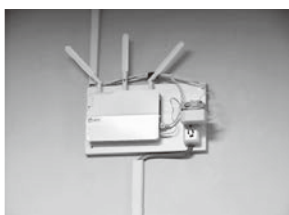
設置されたWi-Fiルーター
