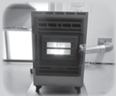
出納室に設置されたペレットストーブ
