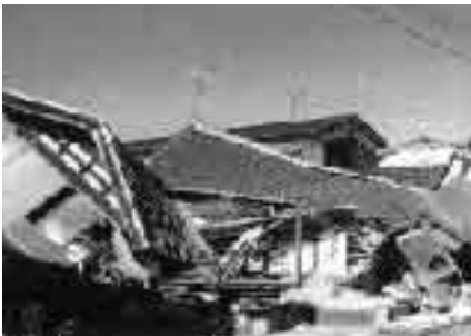
倒壊した家屋
