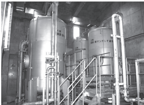
こまち浄水場内部の様子
