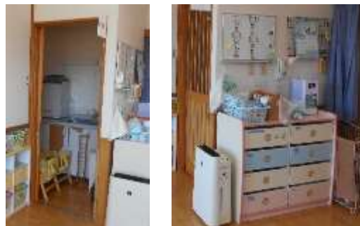
老朽化した給湯室 棚（のり、はさみ等）
