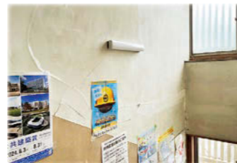
▲多数のひび割れ(2階)
