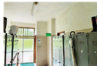
▲多数のひび割れ(1階)
