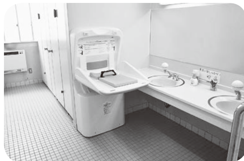
トイレに設置されているベビーシート
